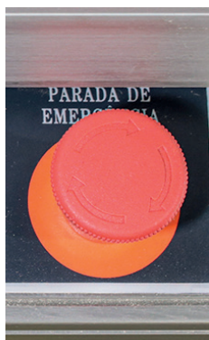
Botoeira Emergência Interligado ao relé de segurança, frontal da máquina
