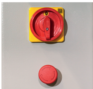
Botoeira Emergência Interligado ao relé de segurança, lateral da máquina.
