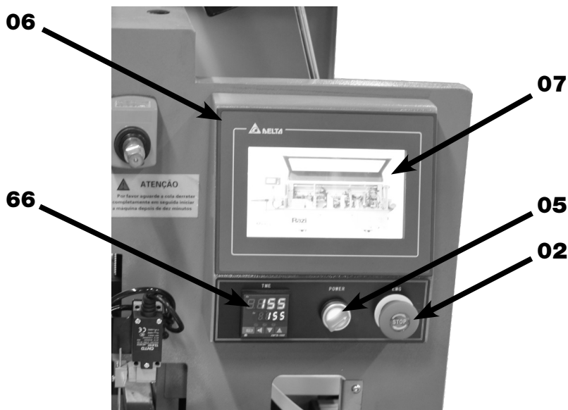
FIGURA 28 – Painel de Comando
